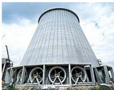
Figura 6 - Torre de refrigeração
