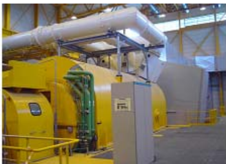
Figura 4 - Vista de um dos alternadores
